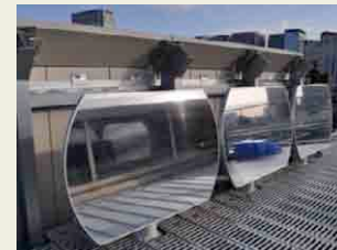
自然光採光(太陽追尾装置)
